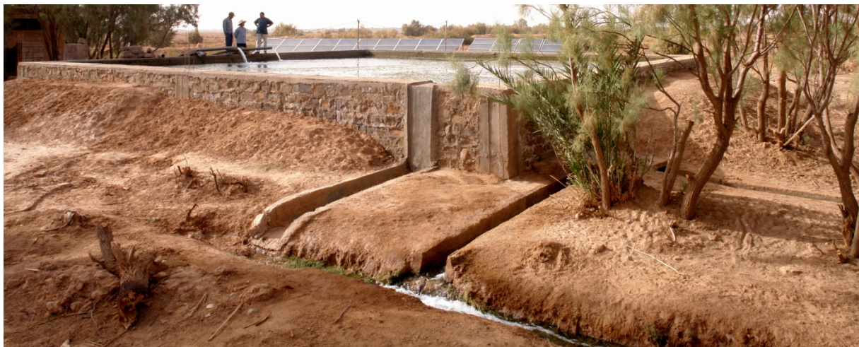
fig.6 Bassins et déversoirs d'une station de pompage datant de 1952, dispensant une eau un peu saline, où le pétrole est désormais remplacé par des panneaux photovoltaïques
